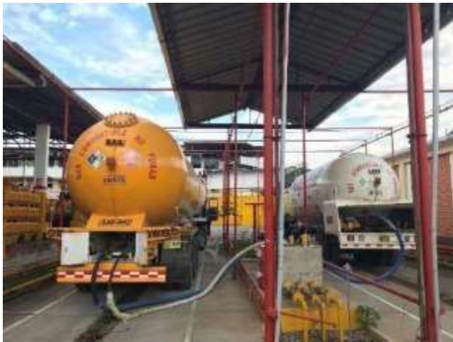
TRASBASE DE GLP A GRANEL
