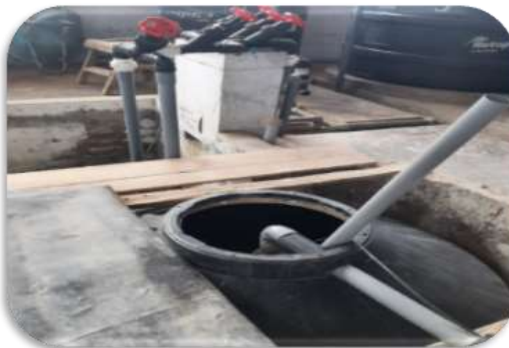
Figura 13: Tanque de Mezcla
