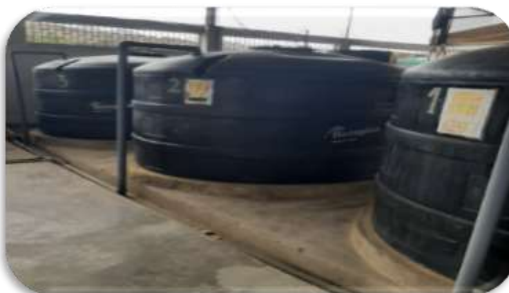
Figura 14: Tanques de soluciones
