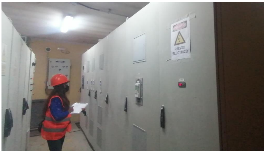
FOTO 10.- Recopilación de información Sala Eléctrica
