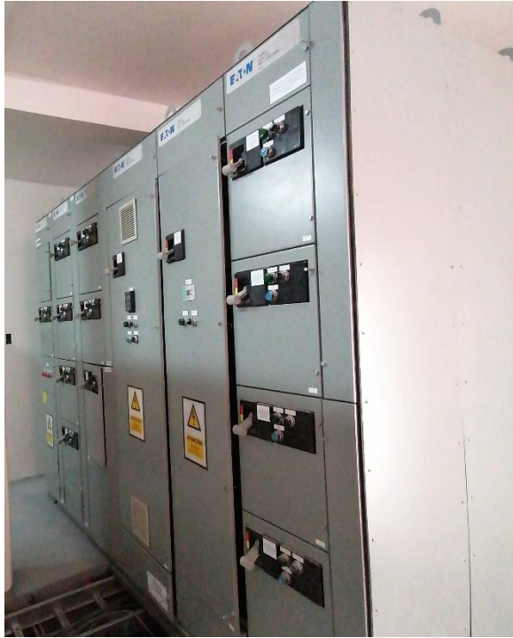
FOTO 9.- Centro de Control de Motores para el Silo 800m 3 (CCM)
