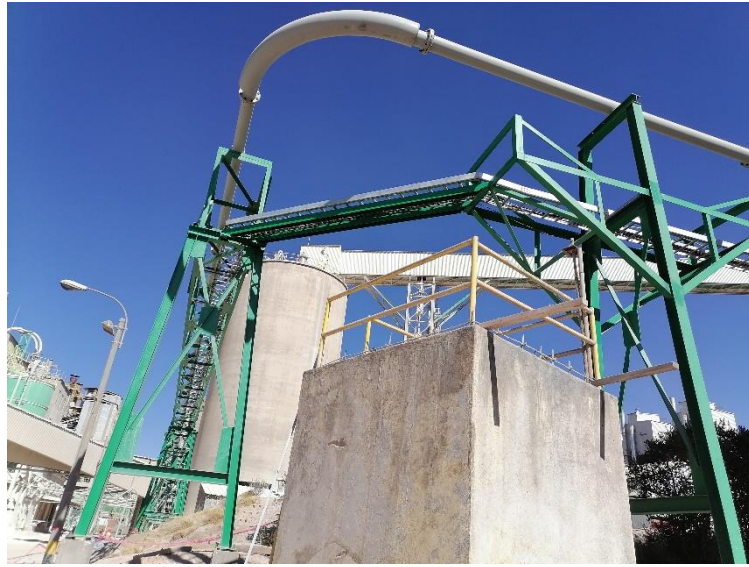
FOTO 5.- Tubería para transporte de Cal – Vista Vértice
