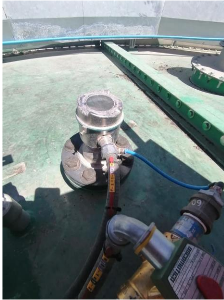
FOTO 11.- Transmisor nivel tolva – radar
