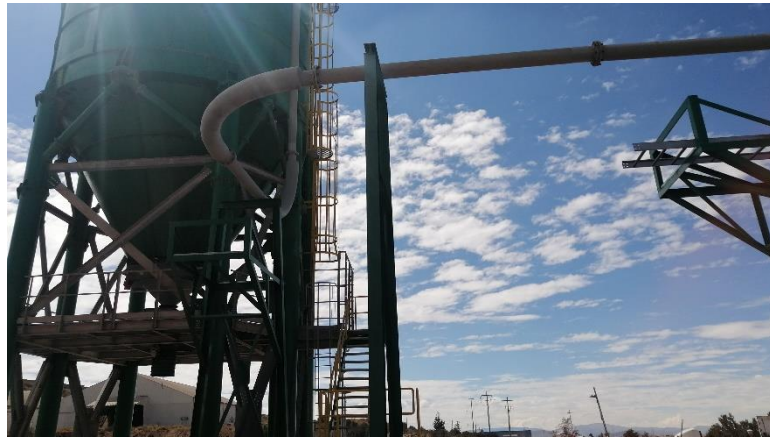
FOTO 7.- Tubería para transporte de Cal – Vista llegada al Silo
