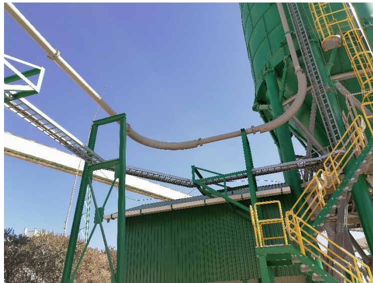
FOTO 6.- Tubería para transporte de Cal – Vista llegada al Silo
