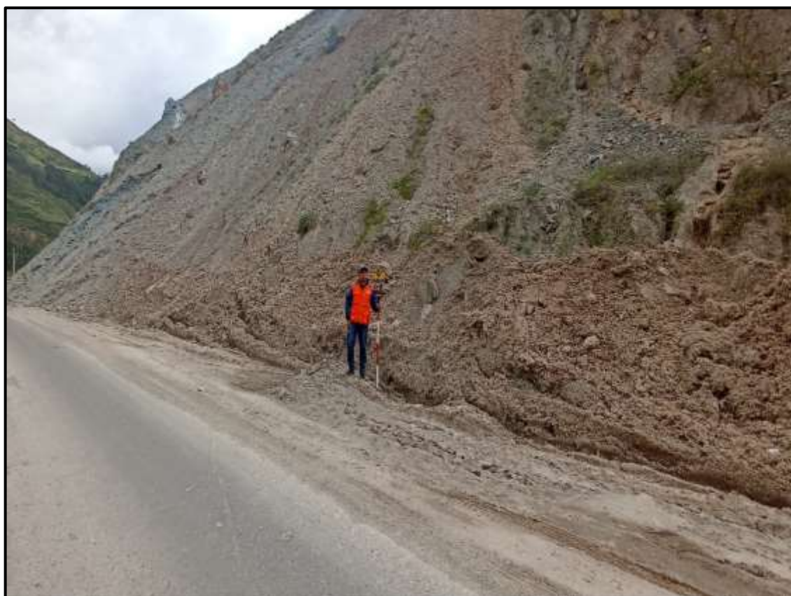
FOTOGRAFÍA N°6. Se observa el deslizamiento del talud, así mismo el levantamiento topográfico.
