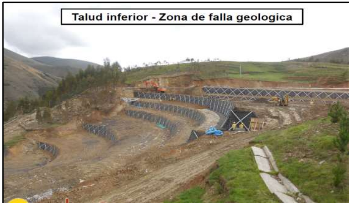
Fotografía 26. Talud inferior con falla geológica en la carretera IIRSA SUR - Km 48+500. (Fuente: Betonform)
