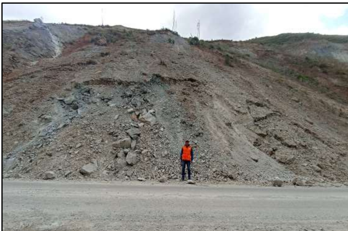
FOTOGRAFÍA N°1. Reconocimiento in situ del estado actual del talud del Km 181+000
