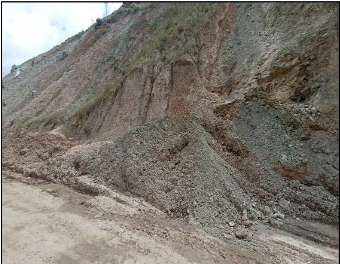
FOTOGRAFÍA N°4. Se observa el deslizamiento rotacional en el talud del Km 181+000 de la carretera central.
