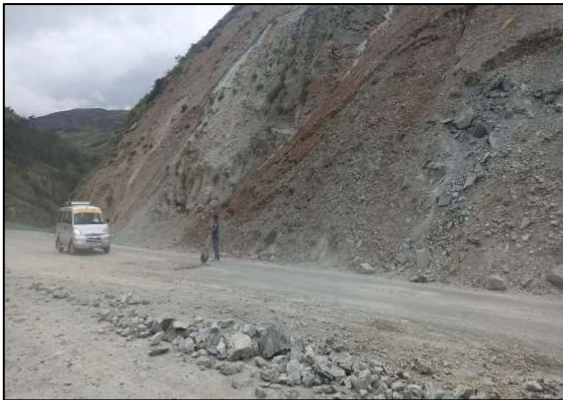
FOTOGRAFÍA N°7. Se muestra rocas sueltas en la carretera producto de los taludes erosionados por falta de estructuras de contención.
