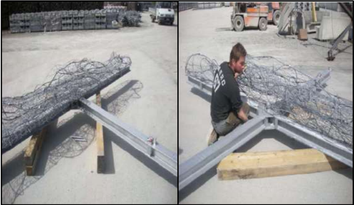
Fotografía 11. Abertura de vigas y colocación de los pernos a la estructura. (Fuente: Betonform)
