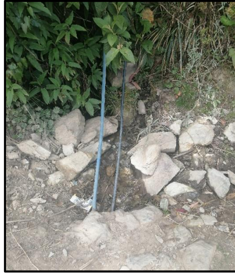
Instalación de agua con manguera ubicado en Churubamba
