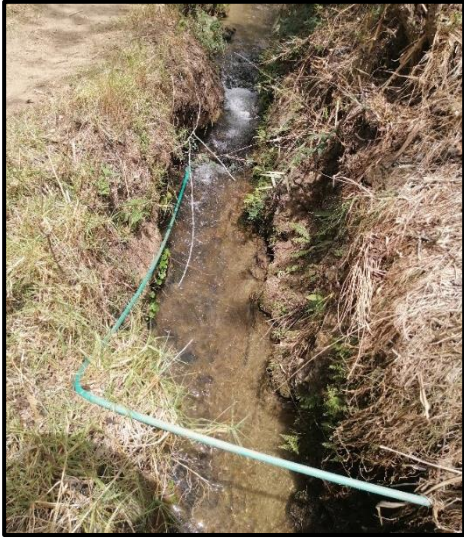
Instalación de agua con manguera ubicado en Cochabamba
