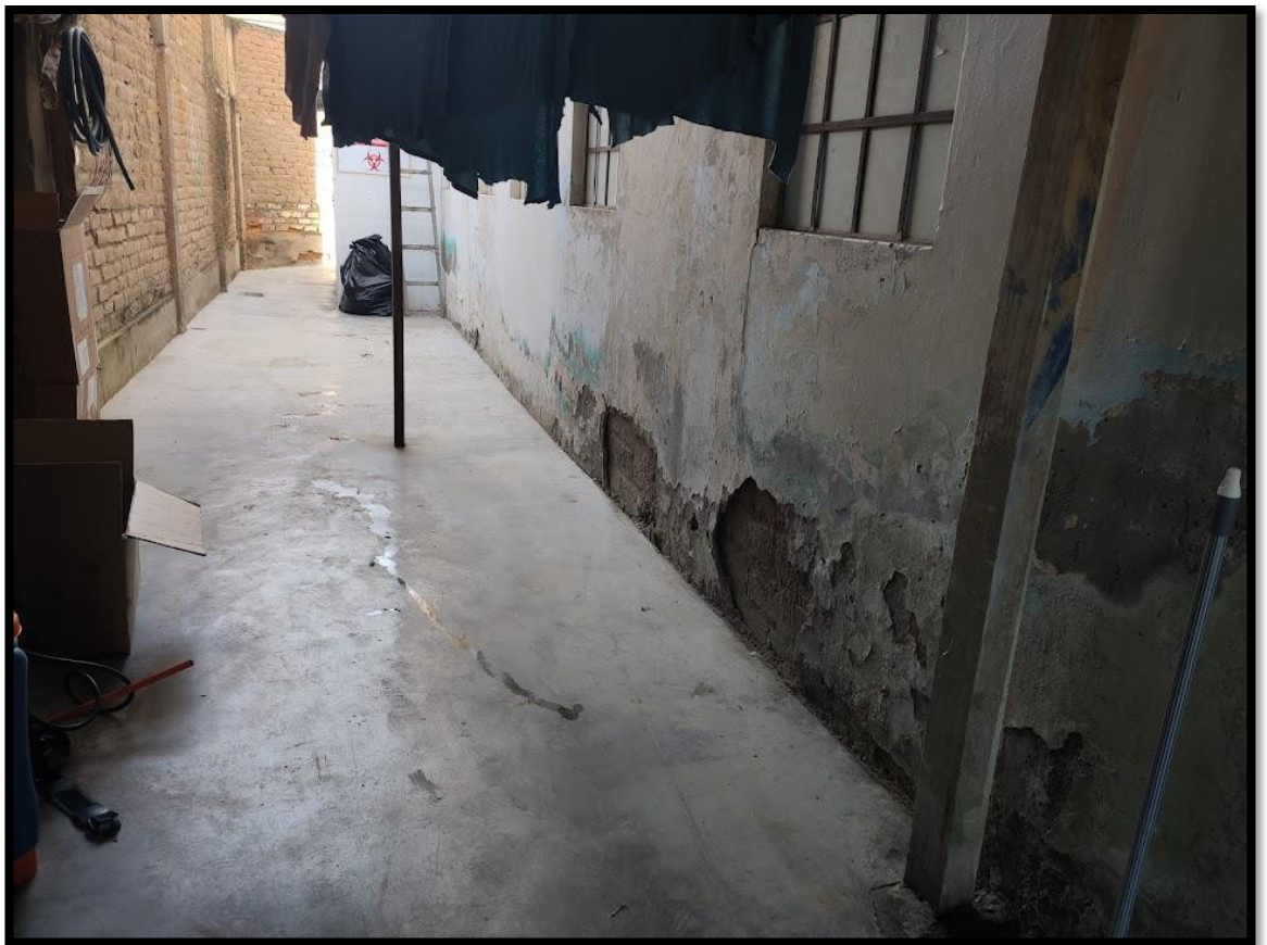
Fotografía 6: Ataque de sulfatos y cloruros en muros del primer nivel.
