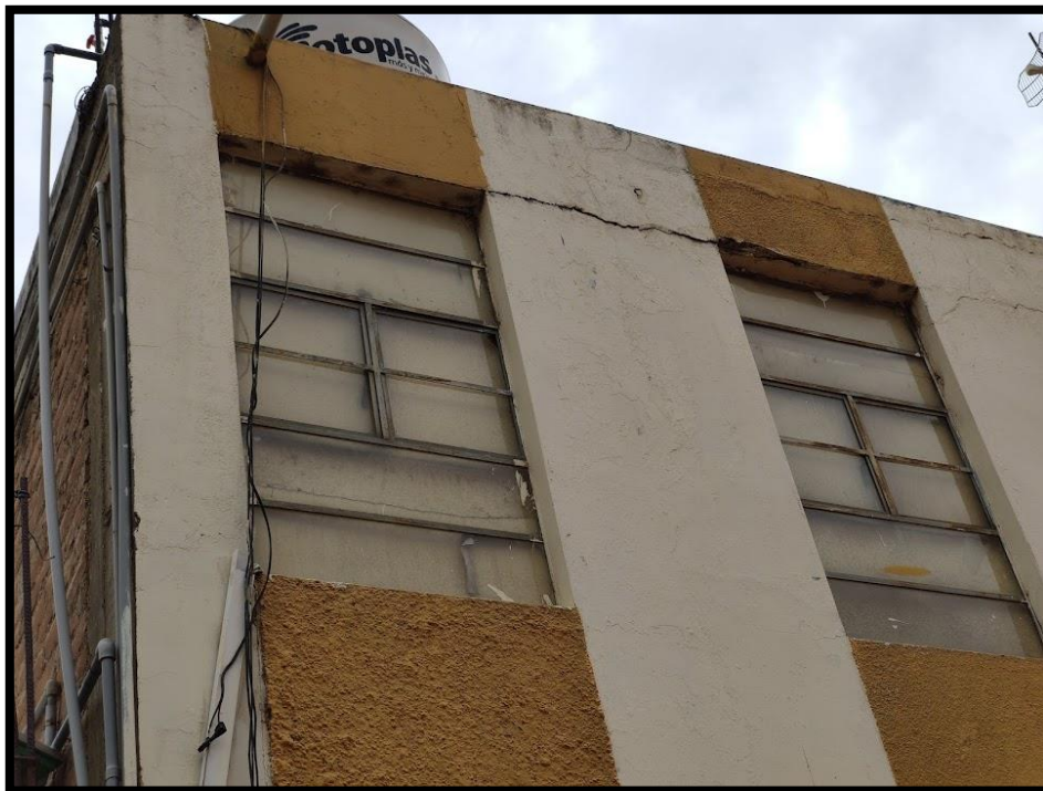
Fotografía 12: Fisuración en muro por dilatación de losa de techo.
