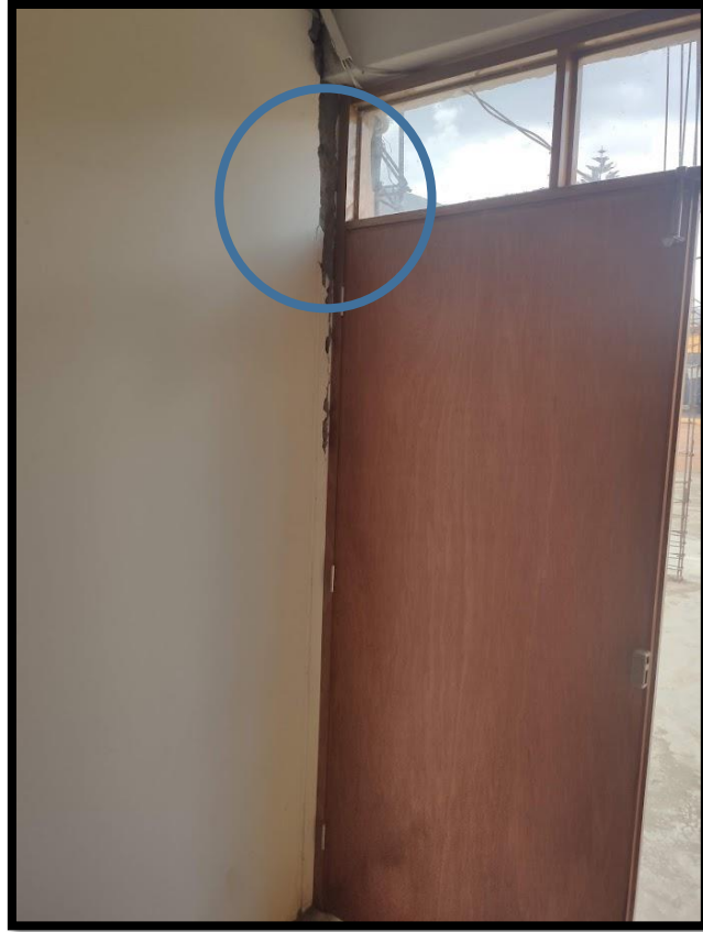
Fotografía 13: Fisuración por rotura o deslizamiento de estribos.
