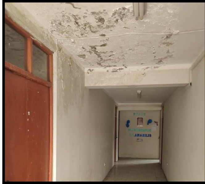
Fotografía 5: Humedad en cielorraso del tercer nivel.
