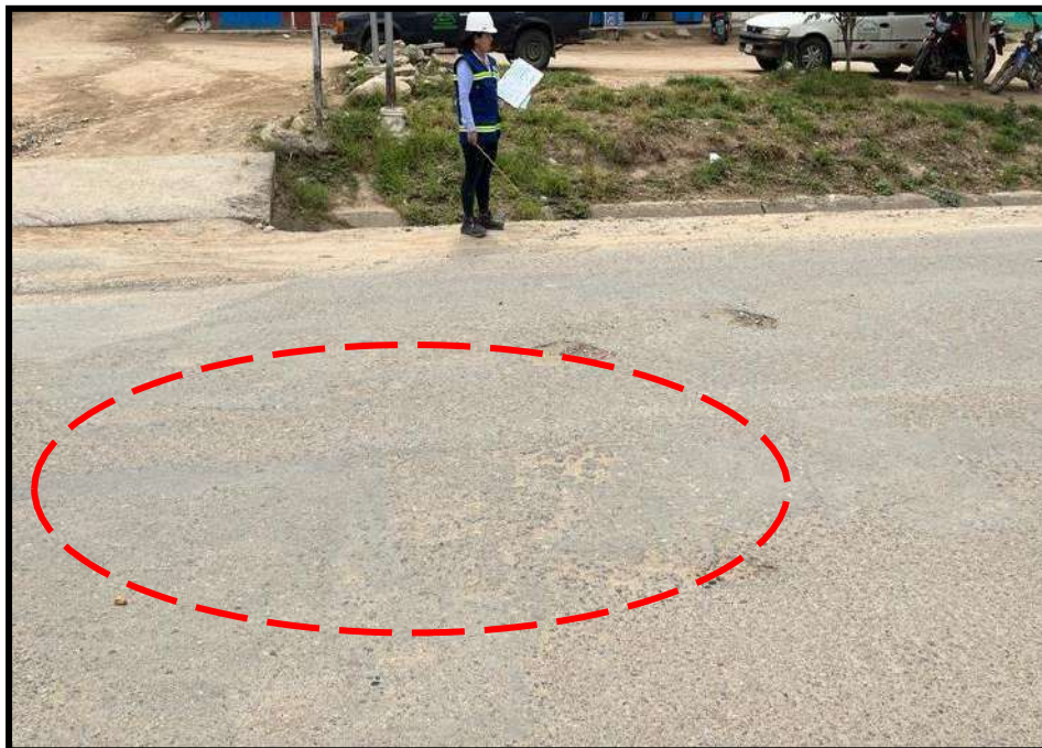
Figura 2 Exudación de severidad bajo , ubicada en la unidad U2, sección 1.
