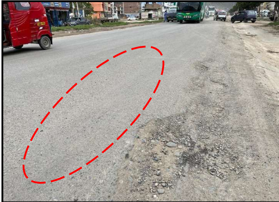
Figura 1 Exudación de severidad bajo , ubicada en la unidad U1, sección 1.
