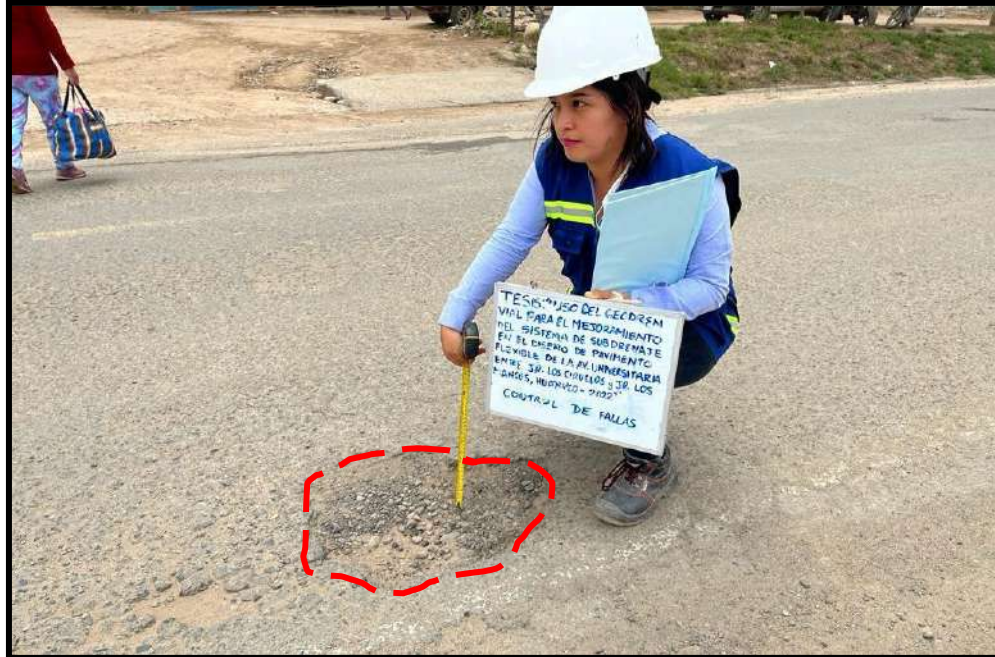
Figura 7 Bache de grado de severidad media , registrado en la unidad de muestra U7, sección 1. Tiene una profundidad de 9 cm y un diámetro de 58 cm.
