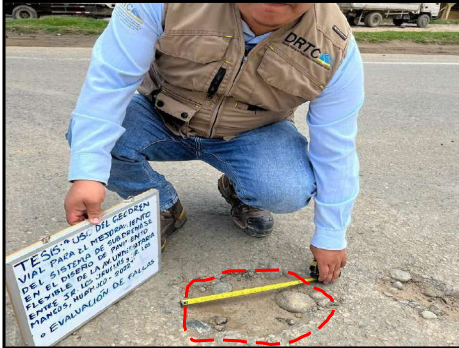
Figura 13 Bache de grado de severidad media , registrado en la unidad de muestra U13, sección 1. Tiene una profundidad de 10 cm y un diámetro de 58 cm.
