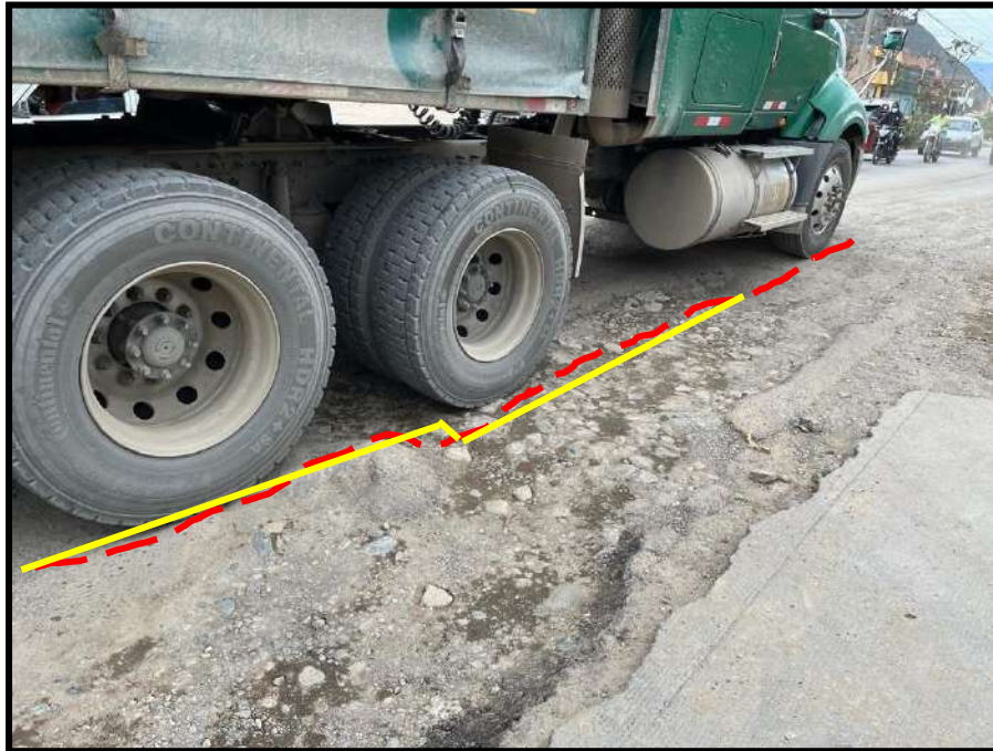
Figura 36 Hundimiento de grado de severidad alto , registrado en la unidad de muestra U36, sección 1. Tiene una profundidad de 12 cm y un diámetro de 2.17 m.
