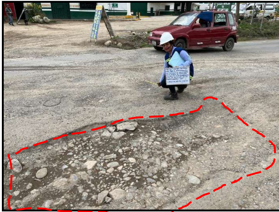
Figura 38 Hundimiento de grado de severidad alto , registrado en la unidad de muestra U38, sección 1. Tiene una profundidad de 12 cm y un diámetro de 1.27 m.
