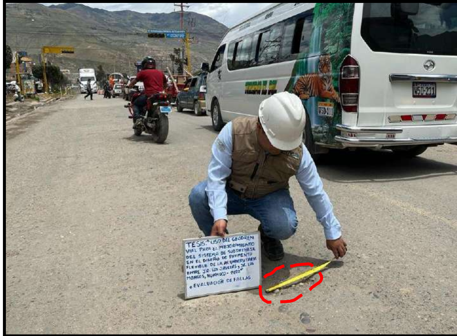
Figura 17 Bache de grado de severidad media , registrado en la unidad de muestra U17, sección 1. Tiene una profundidad de 8 cm y un diámetro de 26 cm.
