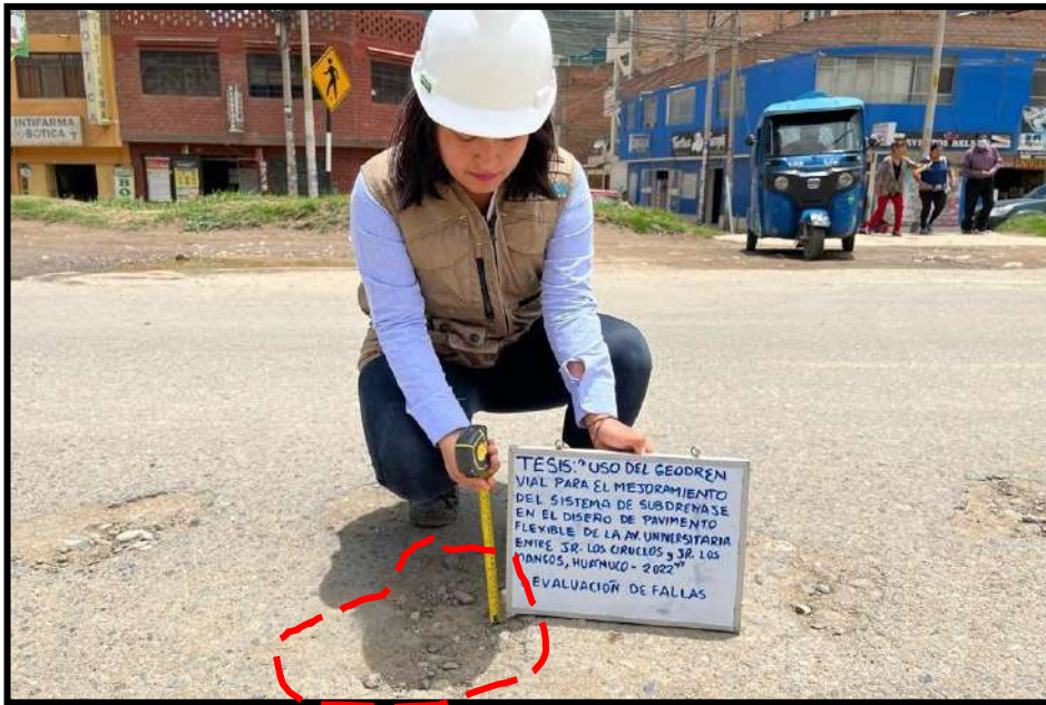
Figura 24 Bache de grado de severidad media , registrado en la unidad de muestra U24, sección 1. Tiene una profundidad de 9 cm y un diámetro de 64 cm.
