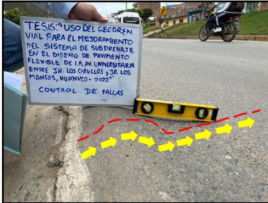
Figura 32 Hinchamiento de grado de severidad alto , registrado en la unidad de muestra U32, sección 1. Se observa cómo el pavimento tiene una protuberancia que intenta “trepar” a la berma.
