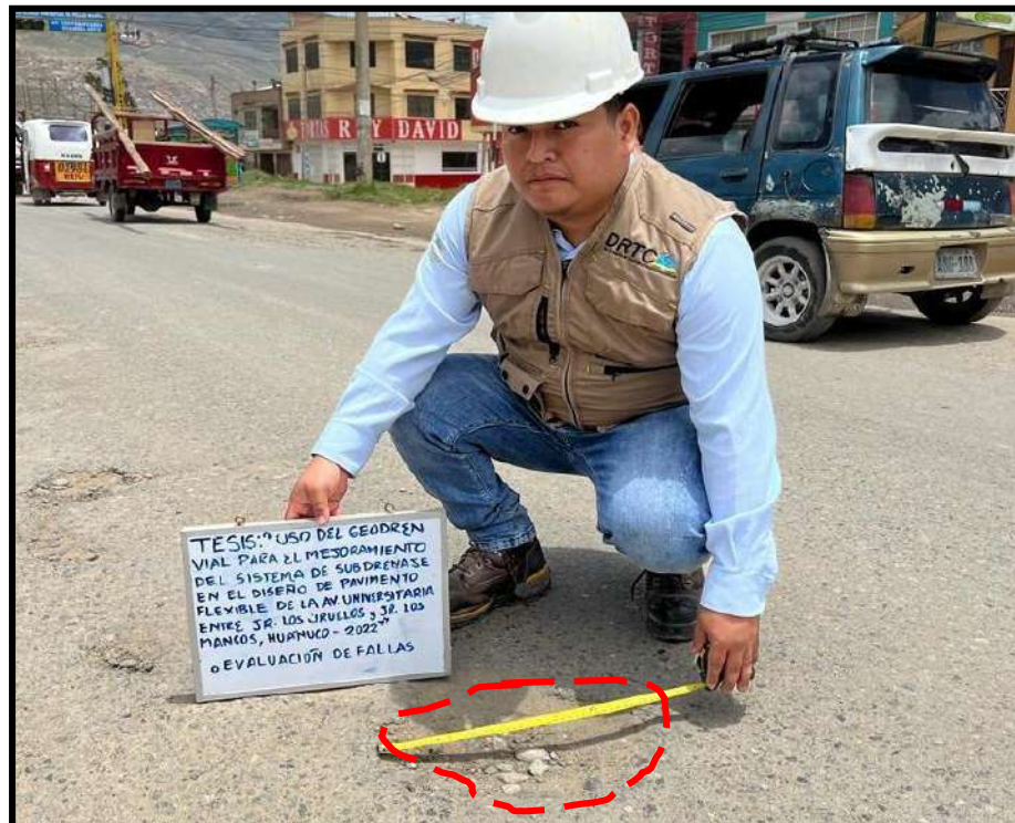
Figura 18 Bache de grado de severidad media , registrado en la unidad de muestra U18, sección 1. Tiene una profundidad de 9 cm y un diámetro de 28 cm.
