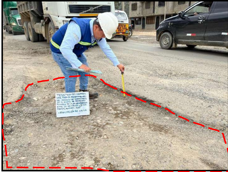
Figura 39 Agrietamiento de borde de grado de severidad alto , registrado en la unidad de muestra U39, sección 1. Tiene una profundidad de 16 cm y un diámetro de 2.21 m.
