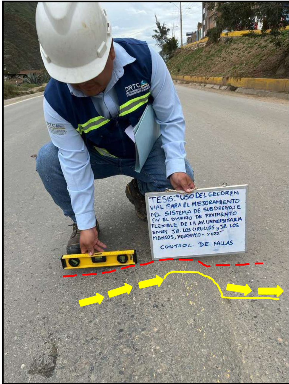
Figura 28 Abultamiento de grado de severidad mediano , registrado en la unidad de muestra U28, sección 1. Tiene una longitud de 92 ml.
