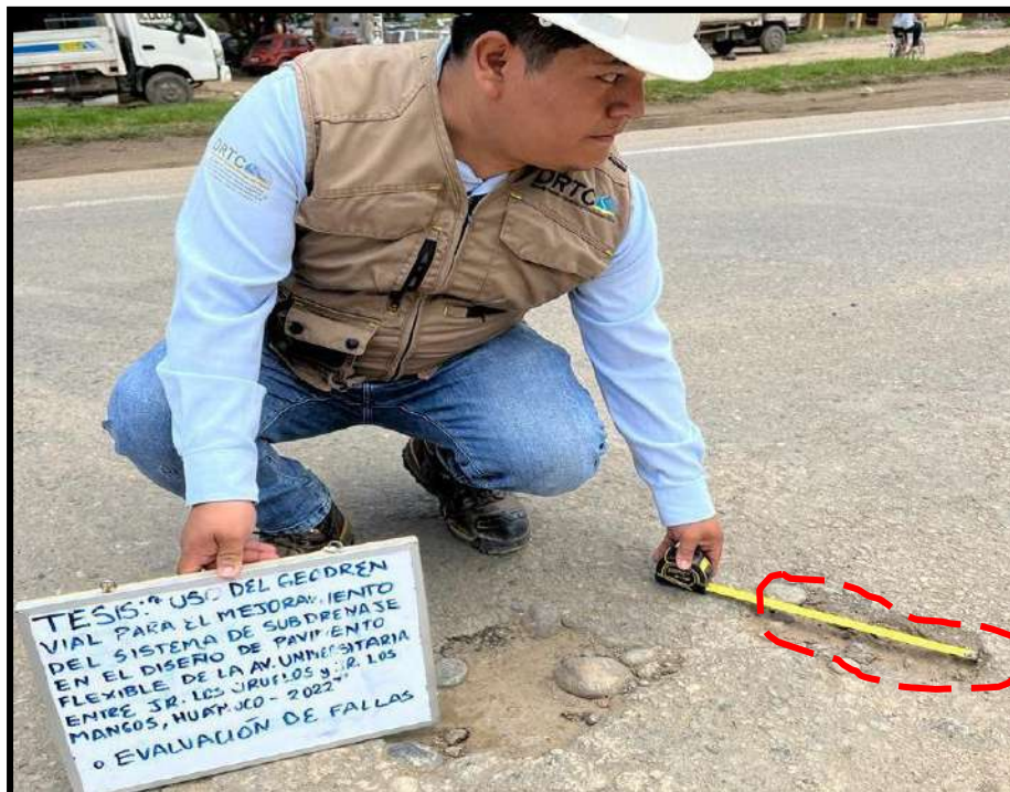
Figura 12 Bache de grado de severidad media , registrado en la unidad de muestra U12, sección 1. Tiene una profundidad de 10 cm y un diámetro de 28 cm.
