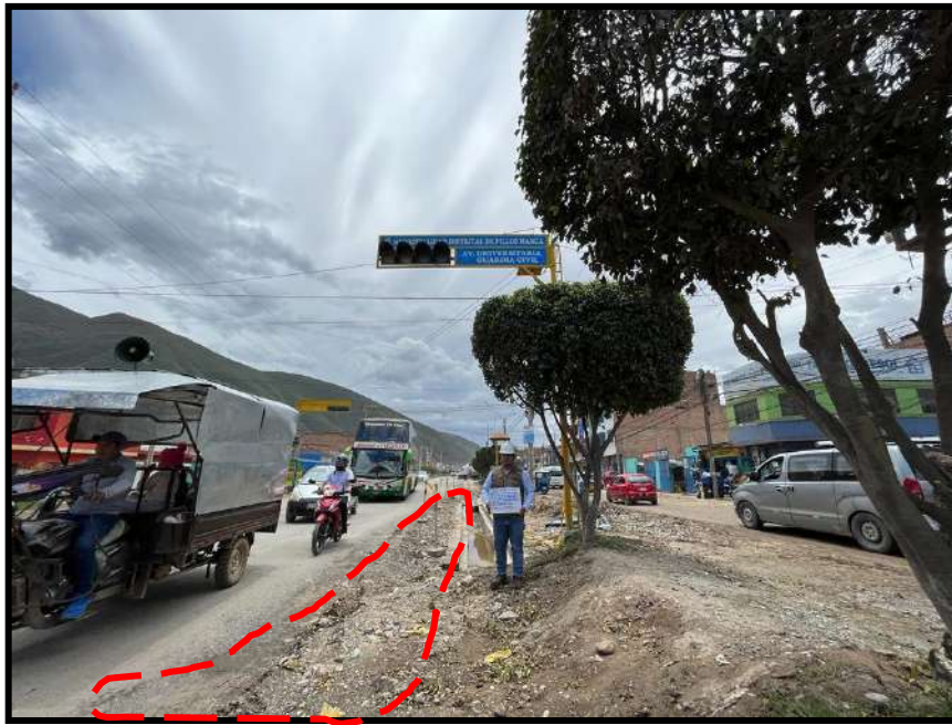
Figura 46 Agrietamiento de borde de grado de severidad alto , registrado en la unidad de muestra U46, sección 1. Tiene una longitud de 4.69 ml.
