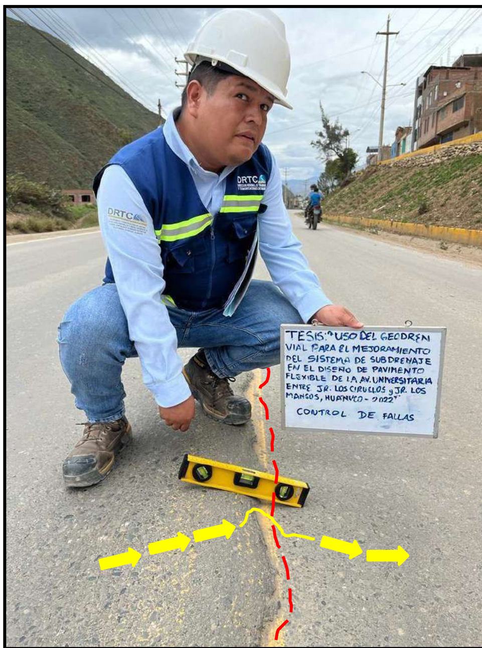
Figura 27 Abultamiento de grado de severidad mediano , registrado en la unidad de muestra U27, sección 1. Tiene una longitud de 87 ml.
