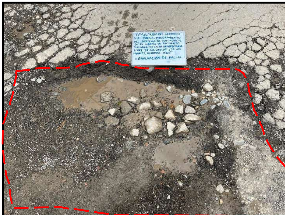
Figura 40 Agrietamiento de borde de grado de severidad alto , registrado en la unidad de muestra U40, sección 1. Tiene una profundidad de 13 cm y un diámetro de 1.07 m.
