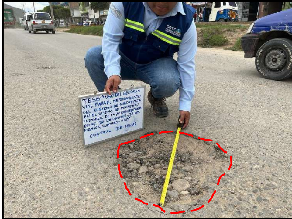
Figura 9 Bache de grado de severidad media , registrado en la unidad de muestra U9, sección 1. Tiene una profundidad de 12 cm y un diámetro de 62 cm.
