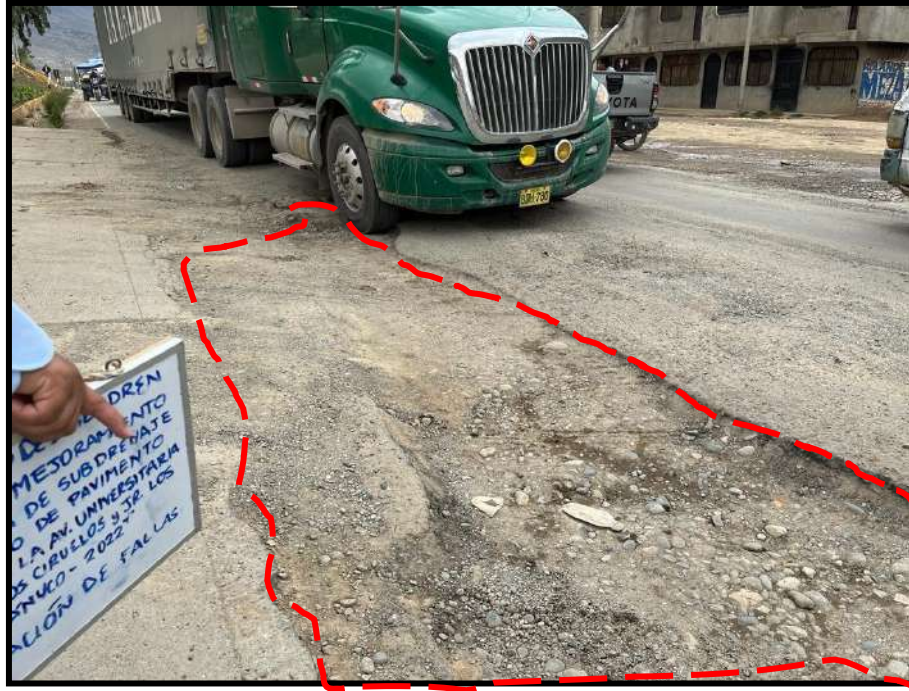
Figura 37 Hundimiento de grado de severidad alto , registrado en la unidad de muestra U37, sección 1. Tiene una profundidad de 13 cm y un diámetro de 2.08 m.
