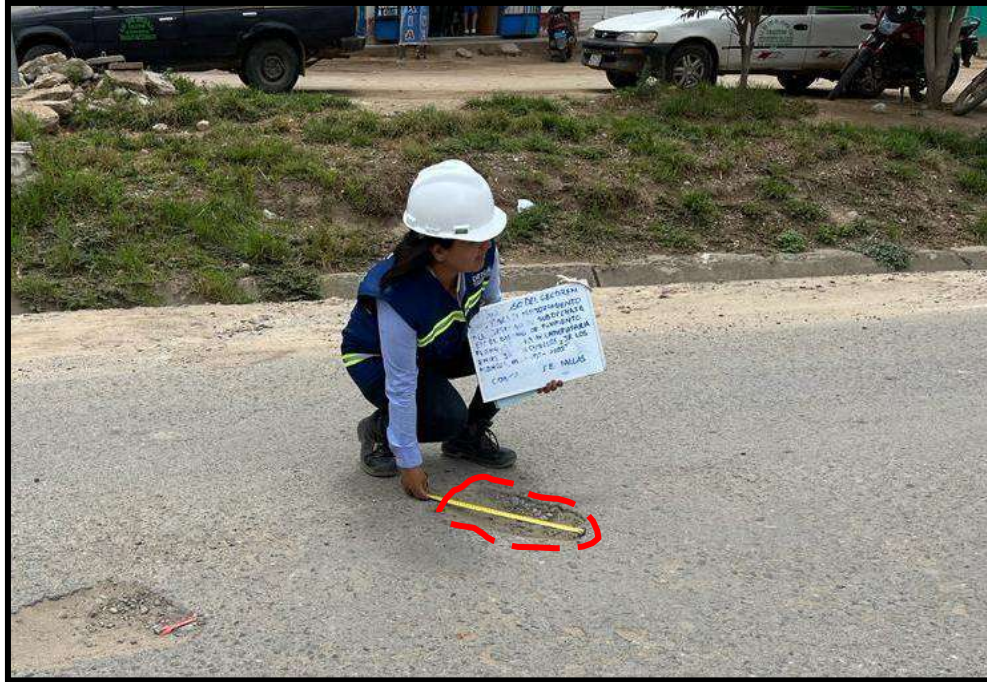
Figura 5 Bache de grado de severidad media , registrado en la unidad de muestra U5, sección 1. Tiene una profundidad de 8 cm y un diámetro de 32 cm.
