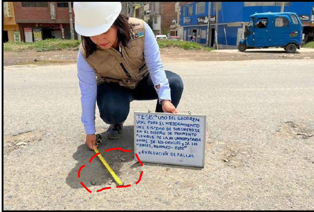
Figura 25 Bache de grado de severidad media , registrado en la unidad de muestra U25, sección 1. Tiene una profundidad de 9 cm y un diámetro de 63 cm.
