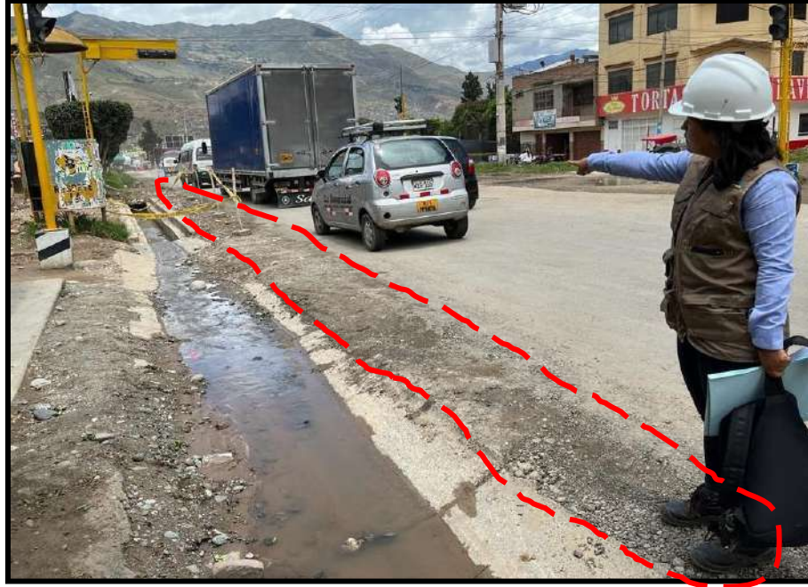
Figura 41 Agrietamiento de borde de grado de severidad alto , registrado en la unidad de muestra U41, sección 1. Tiene una longitud de 87 ml.
