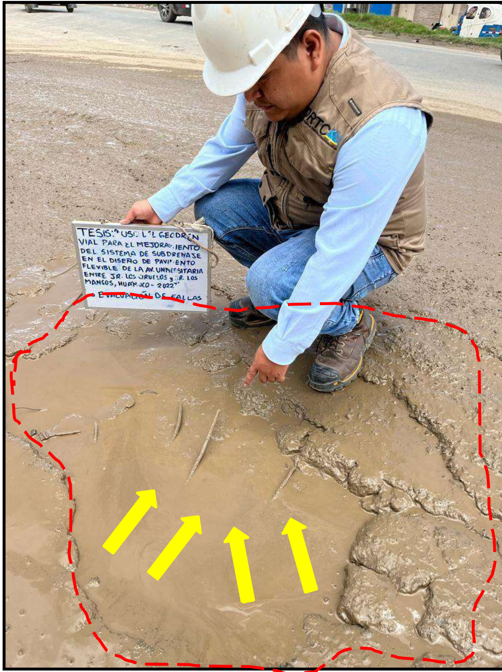
Figura 48 Bache de grado de severidad alto , registrado en la unidad de muestra U48, sección 1. Tiene una longitud de 1.17 ml y un ancho de 1.28 ml.
