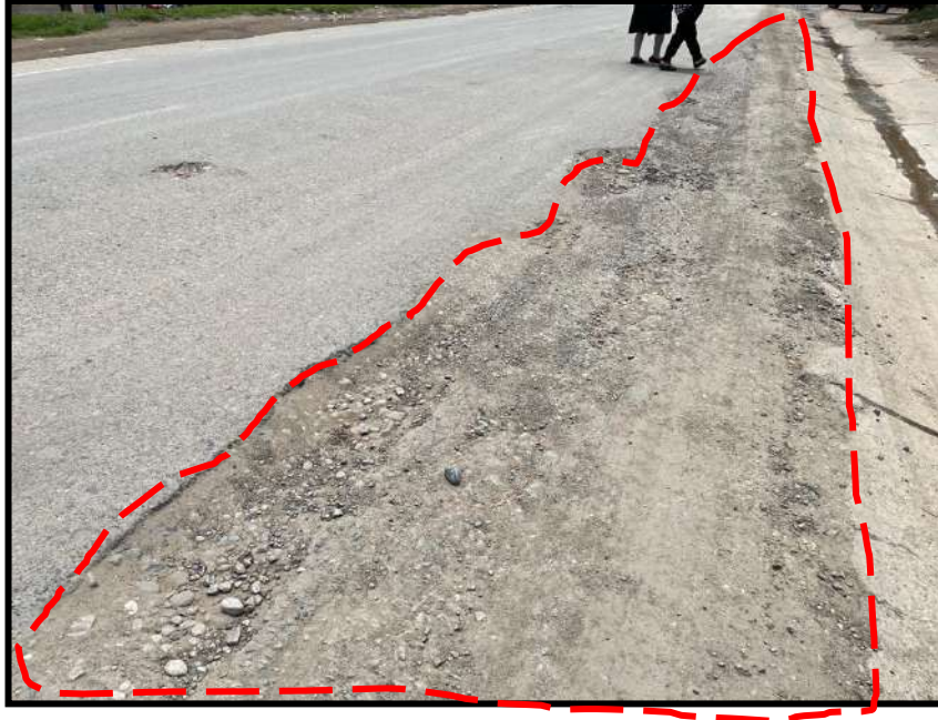
Figura 45 Agrietamiento de borde de grado de severidad alto , registrado en la unidad de muestra U45, sección 1. Tiene una longitud de 2.64 ml.
