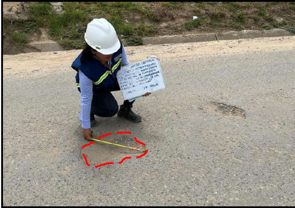
Figura 3 Bache de grado de severidad media , registrado en la unidad de muestra U3, sección 1. Tiene una profundidad de 9 cm y un diámetro de 43 cm.
