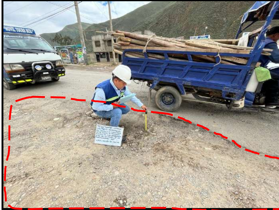
Figura 35 Hundimiento de grado de severidad alto , registrado en la unidad de muestra U35, sección 1. Tiene una profundidad de 14 cm y un diámetro de 2.41 m.
