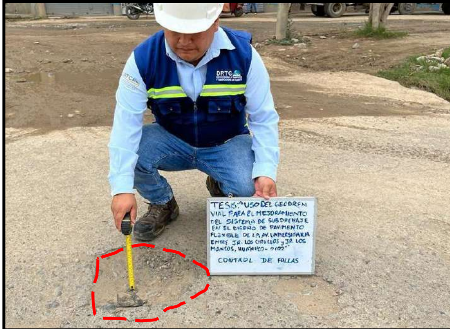
Figura 11 Bache de grado de severidad media , registrado en la unidad de muestra U11, sección 1. Tiene una profundidad de 8 cm y un diámetro de 41 cm.
