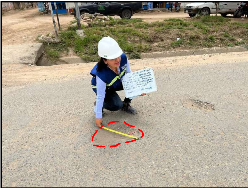
Figura 4 Bache de grado de severidad media , registrado en la unidad de muestra U4, sección 1. Tiene una profundidad de 9 cm y un diámetro de 43 cm.
