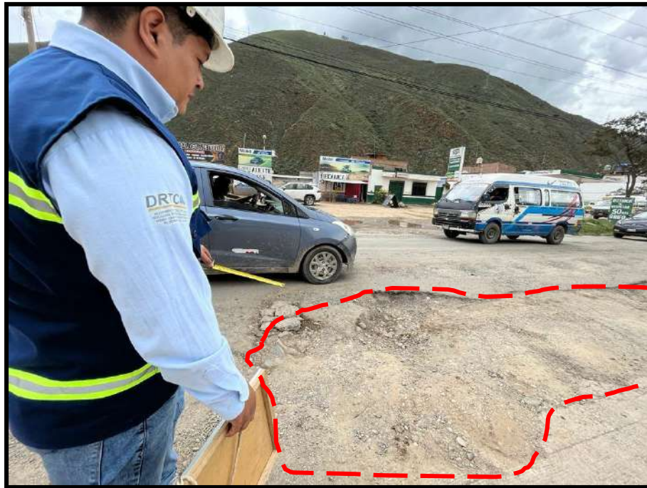
Figura 34 Hundimiento de grado de severidad alto , registrado en la unidad de muestra U34, sección 1. Tiene una profundidad de 16 cm y un diámetro de 1.77 m.
