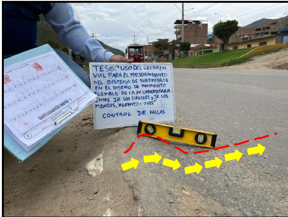
Figura 31 Hinchamiento de grado de severidad alto , registrado en la unidad de muestra U31, sección 1. Se observa cómo el pavimento tiene una protuberancia que intenta “trepar” a la berma.
