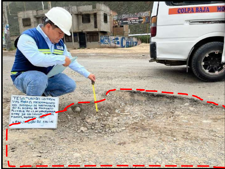
Figura 33 Hundimiento de grado de severidad alto , registrado en la unidad de muestra U33, sección 1. Tiene una profundidad de 17 cm y un diámetro de 1.39 m.
