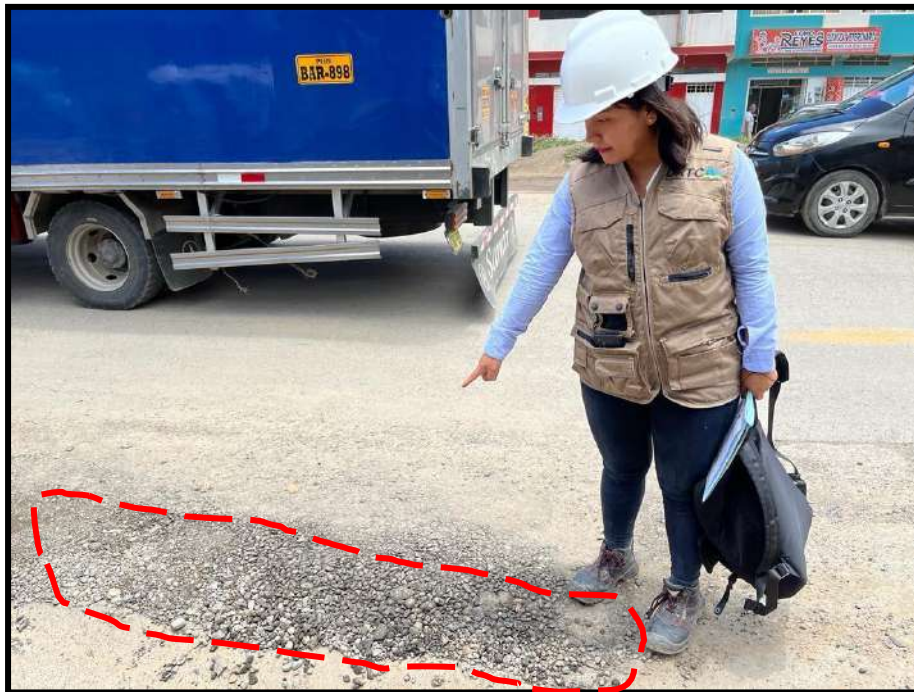
Figura 42 Agrietamiento de borde de grado de severidad alto , registrado en la unidad de muestra U42, sección 1. Tiene una longitud de 96 ml.
