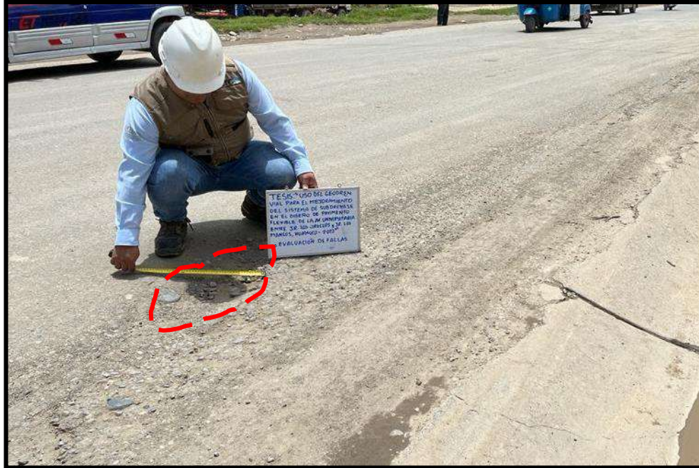
Figura 21 Bache de grado de severidad alto , registrado en la unidad de muestra U21, sección 1. Tiene una profundidad de 8 cm y un diámetro de 37 cm.
