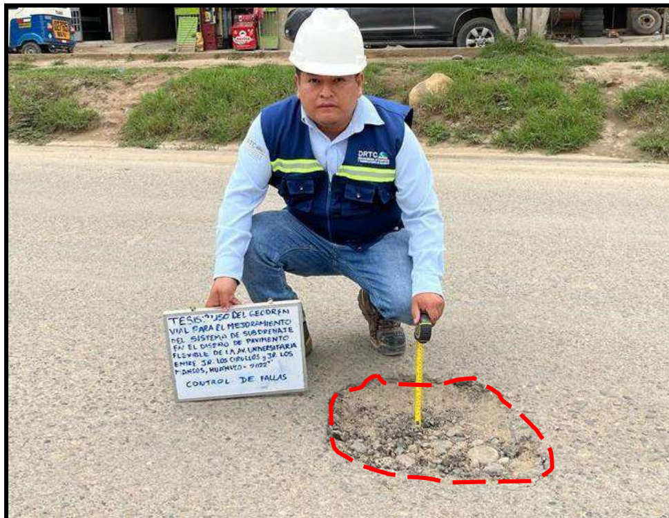
Figura 10 Bache de grado de severidad media , registrado en la unidad de muestra U10, sección 1. Tiene una profundidad de 10 cm y un diámetro de 53 cm.
