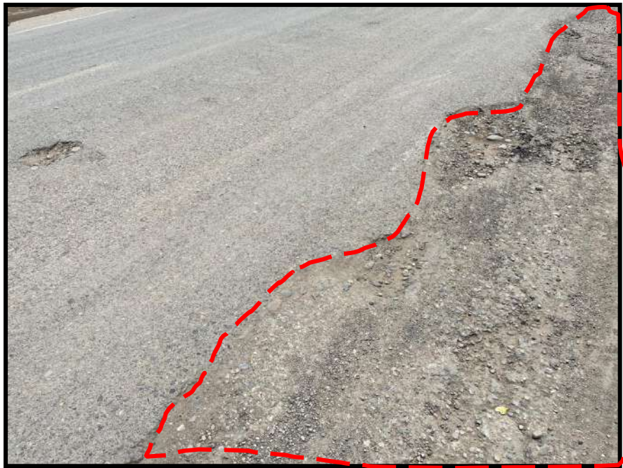
Figura 44 Agrietamiento de borde de grado de severidad alto , registrado en la unidad de muestra U44, sección 1. Tiene una longitud de 1.38 ml.
