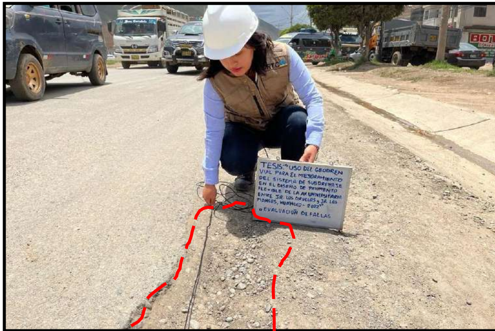
Figura 22 Bache de grado de severidad alto , registrado en la unidad de muestra U22, sección 1. Tiene una profundidad de 10 cm y un diámetro de 87 cm.
