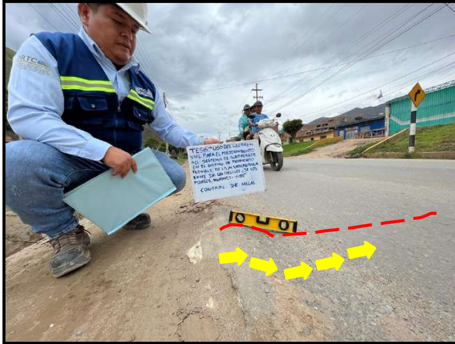
Figura 30 Hinchamiento de grado de severidad alto , registrado en la unidad de muestra U30, sección 1. Se observa cómo el pavimento tiene una protuberancia que intenta “trepar” a la berma.
