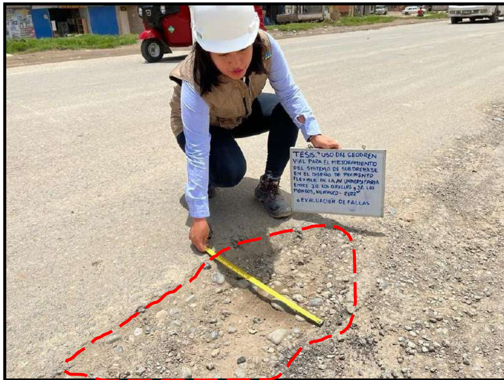
Figura 26 Bache de grado de severidad alto , registrado en la unidad de muestra U26, sección 1. Tiene una profundidad de 12 cm y un diámetro de 96 cm.
