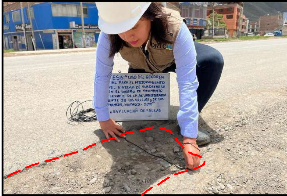
Figura 23 Bache de grado de severidad alto , registrado en la unidad de muestra U23, sección 1. Tiene una profundidad de 12 cm y un diámetro de 58 cm.
