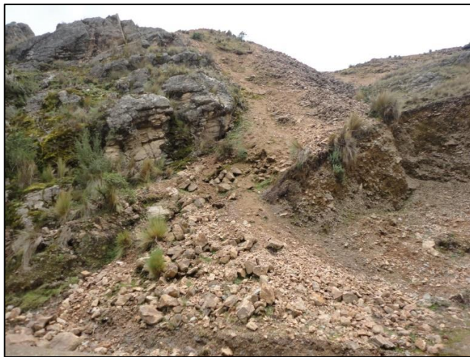
Progresiva 27 + 100KM (100 metros de largo) Caída de rocas y material de arrastre al lado derecho de la vía
