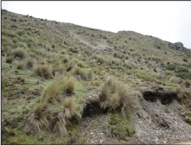
Progresiva 27 + 180KM (50 metros de largo) La carretera se ve afectada por estos deslizamientos.
