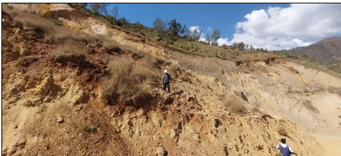
Imagen 02: En la imagen se puede observar el diagnostico in situ del deslizamiento de talud en estudio en el tramo Rancho-Panao km 42.
