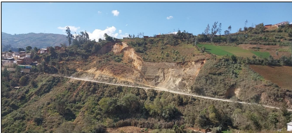
Imagen 06: En la imagen se puede observar el deslizamiento completo de talud en estudio del tramo Rancho-Panao km 42.
