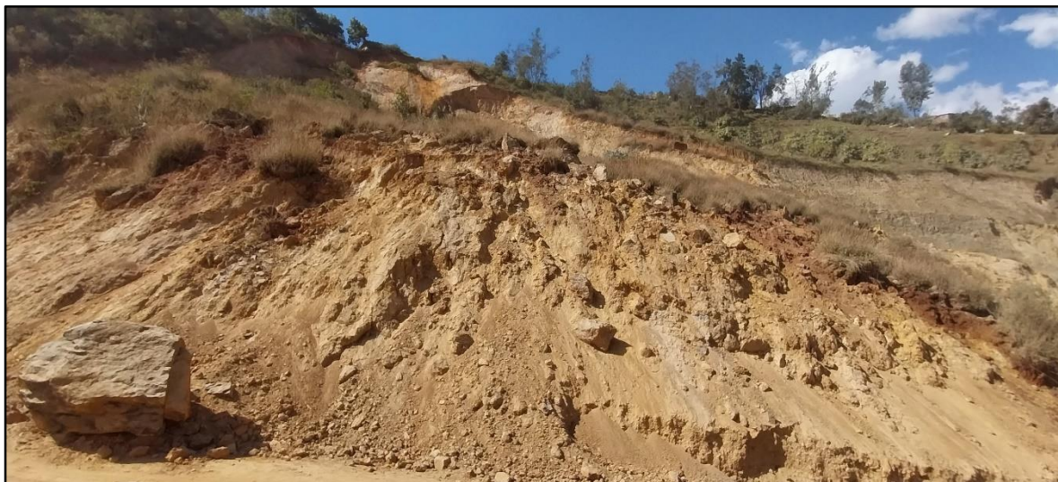
Imagen 01: En la imagen se puede observar el deslizamiento de talud en estudio en el tramo Rancho-Panao km 42.
