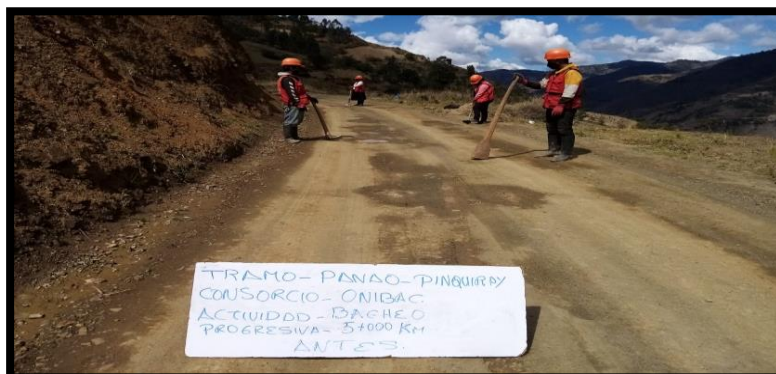
Figura 5 . Bacheo (Antes de las actividades de MVR)
