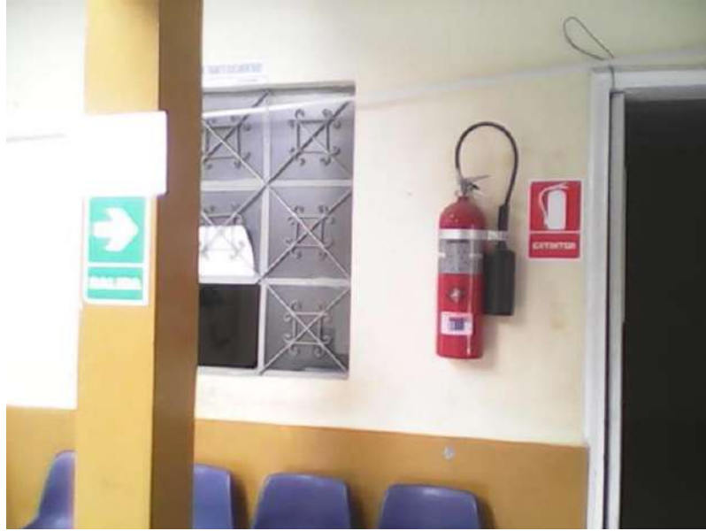
Imagen N° 21: Estado situacional de la señalización existente; Fuente: Di Liberto Moreno (2016)
