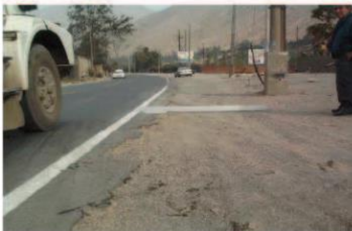
Figura N°11 Gravedad 3: Daños en más del 30% del área de bermas
