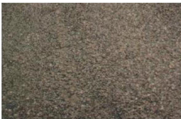
Figura N°5 Gravedad 1: Puntual sin aparición de la base granular (peladura superficial)
