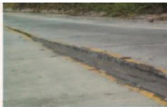
Figura N°2 Gravedad 3: Resulta en una reducción drástica de la velocidad (Desnivel entre losas)
