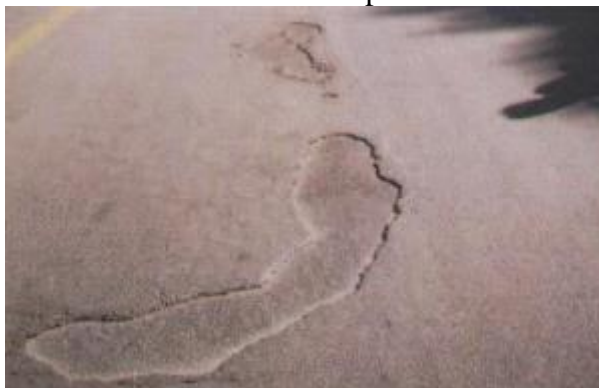
Figura N°6 Gravedad 2: Puntual sin aparición de la base granular
