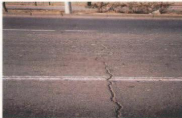
Figura N°9 Gravedad 3: Fisuras gruesas corresponden a fisuras abiertas y/o ramificadas ancho >3 mm). También denominadas grietas
