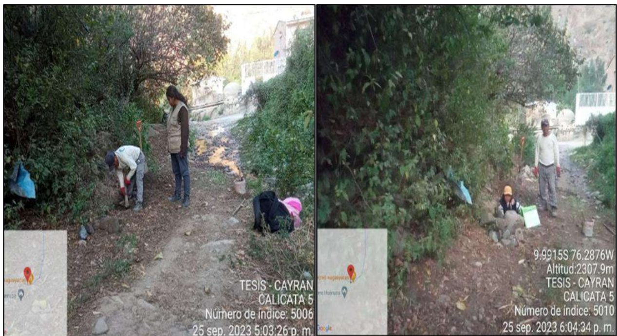
Ilustración 130: Calicata N° 5 QUEBRADA HUAGASYACU– Profundidad: 1.05mts. – Se encontró Nivel Freático – Nos permitirá ver los diferentes estratos para nuestro estudio Granulométrico y poder determinar nuestro Nivel de Riesgo por Detritos.
