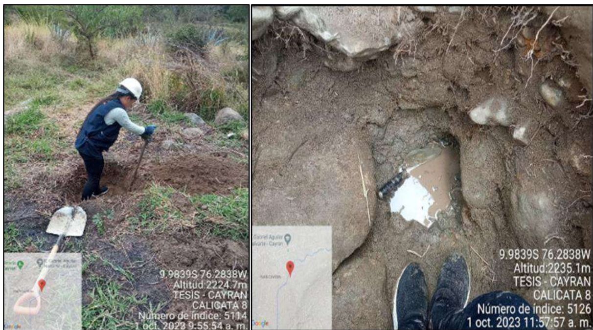
Ilustración 133: Calicata N° 8 FAJA MARGINAL DEL RIO C.P. SAN FRANCISCO DE CAYRAN – Profundidad: 1.10mts. – Se encontró Nivel Freático – Nos permitirá ver los diferentes estratos para nuestro estudio Granulométrico y poder determinar nuestro Nivel de Riesgo por Detritos.
