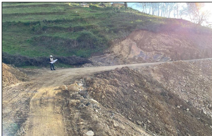
Figura 12 Vista del punto de falla (curva H. 8) – radio de curvatura menor a 15m
